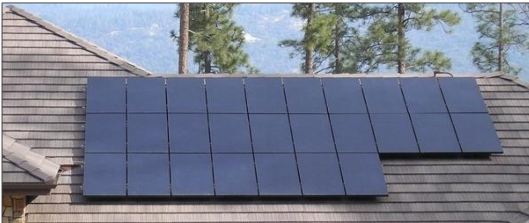
Figur 3-2. Eksempel på solceller på tak (BAPV).
