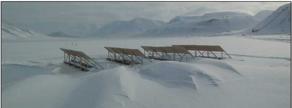
Figur 3-5. Testanlegget i Adventdalen viser prinsippet for hvordan bakkemonterte solcelleanlegg bygges. Foto: Bjørn Thorud, Multiconsult Norge AS.
