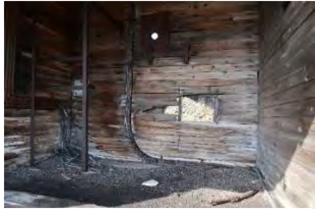
Figur 6: Detalj av rommets bakvegg i NV. Kraftige vaiere, nå kappet, leder ut av rommet. (En avkappet vaier ble gjenfunnet like ovenfor A120). Mot NV.
