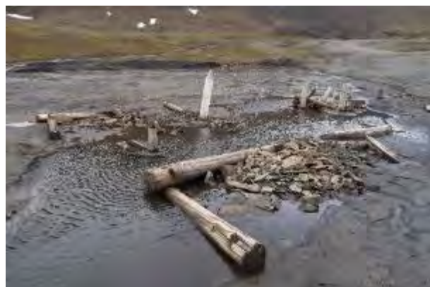
Figur 2: Tuften har vært fundamentert på tre laftekasser fylt med stein. Mot NNV.
