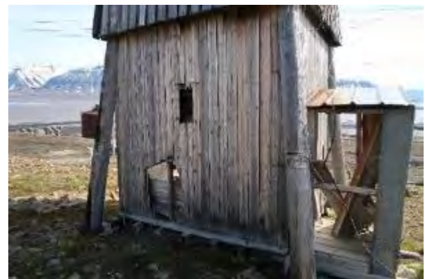
Figur 4: Nærbilde av baksiden, hvor man kan se hullet i bakveggen og hullet bak på skuret, tatt mot Ø.
