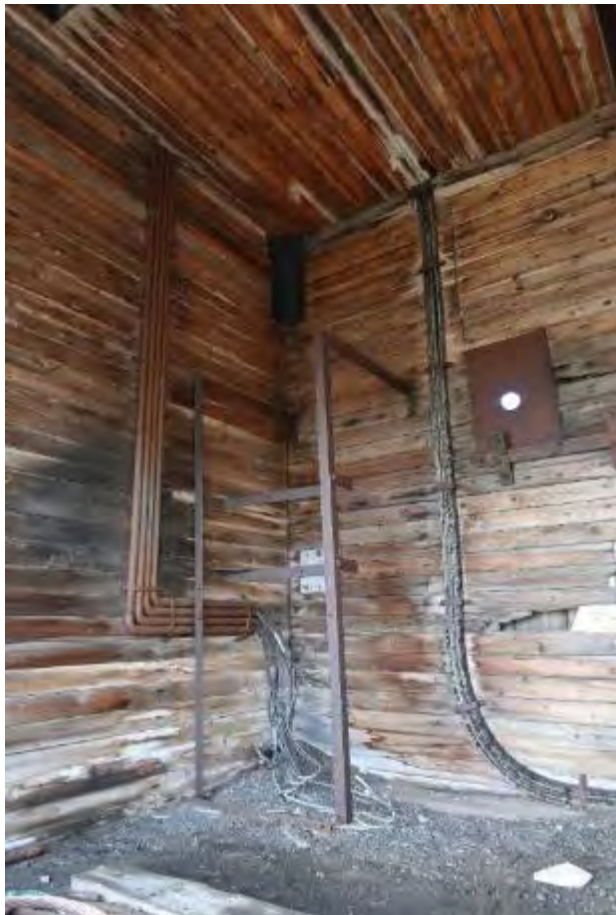
Figur 7: Detalj av rommet i V hjørne. Oppsett til rørledninger, jernstativ, tre vaiere. Mot V.
