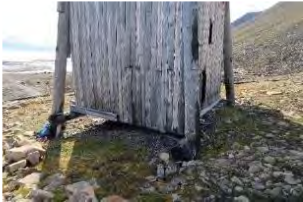
Figur 5: Nærbilde av byggets NØ hjørne. Synlig råte i pælene. Tatt mot SV.
